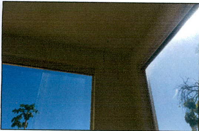
FIGURA 03 - Manchas nas paredes
