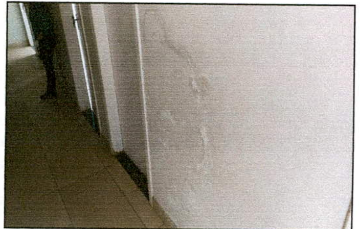
FIGURA 04 - Pintura interna danificada
