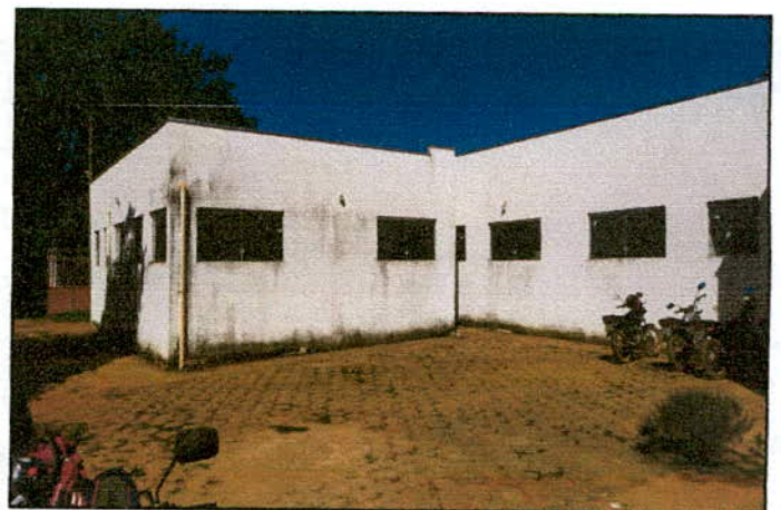
FIGURA 06 - Pintura externa danificada
